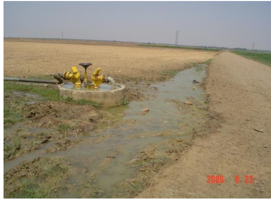
Fig. 2 : Fuite au niveau de la borne bloc compacte aspersione du secteur Nord 5 du Gharb Maroc
