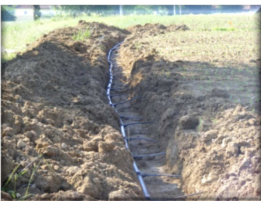
Figure 2 : installation du dispositif GGE
