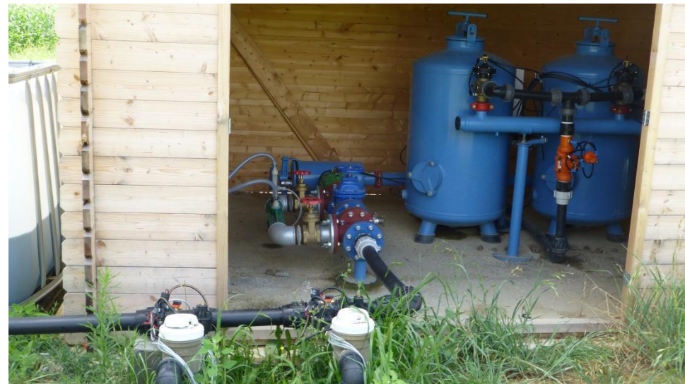
La station de filtration
