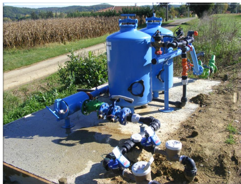
Station de filtration avec 2 départs
